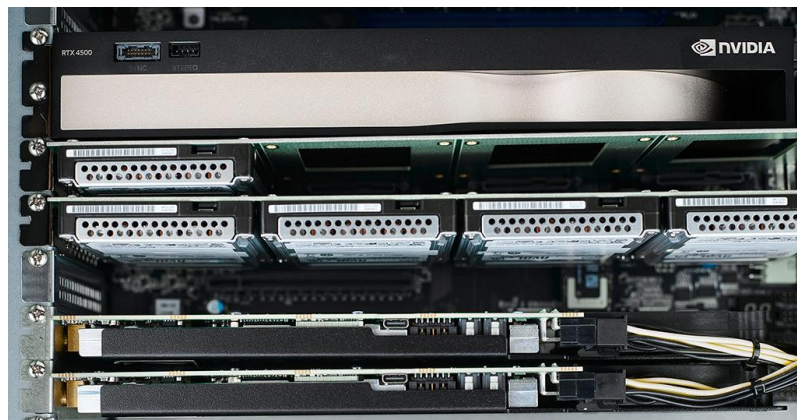
Figure9 : デジタイザ、NVIDIA RTX4500 GPU、および SSD モジュールを備えたデータ収集システム
